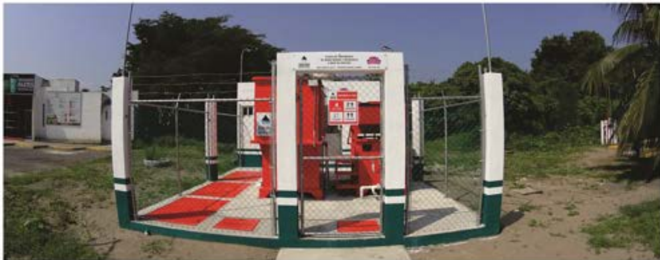
Grupo Ferche S.A. de C.V. Estación de Servicios La Antigua, Ver. Cap. 10m 3 /día.
